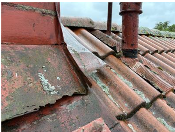
Skorsten: Fogsläpp finns på skorsten. Väderskydd/huv finns ej
