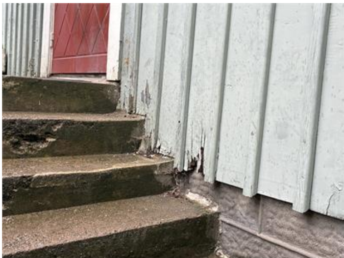
Fasad: Rötskador finns lokalt i fasad på södersida då entrétak ej har hängränna som leder bort dess vatten.
