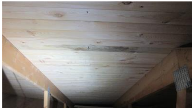
Exempelbild på fuktfläck på vinden.
