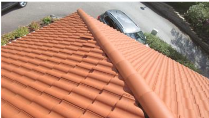
Takpannor som ligger i fel läge.
