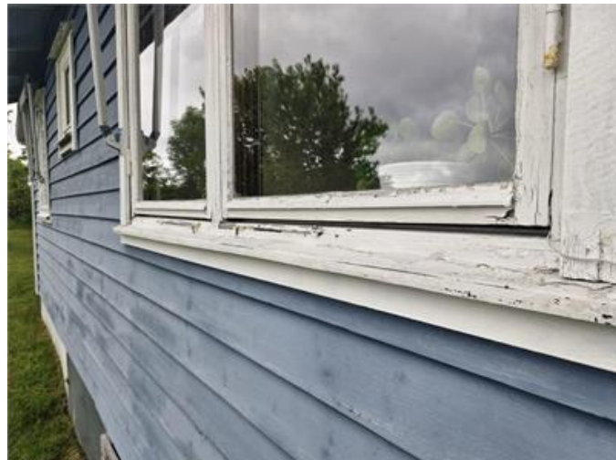
Fasad och Fönster, äldre med underhållsbehov.
