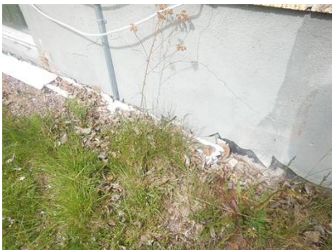
Sprickbildning i grundmur samt kantlist på utvändigt fuktskydd som är bristfälligt.
