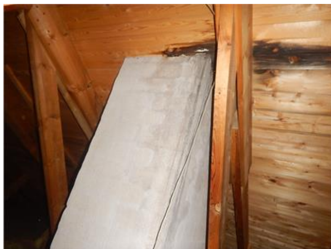
Fuktfläck mot murstock där även förhöjda fuktvärden uppmättes.
