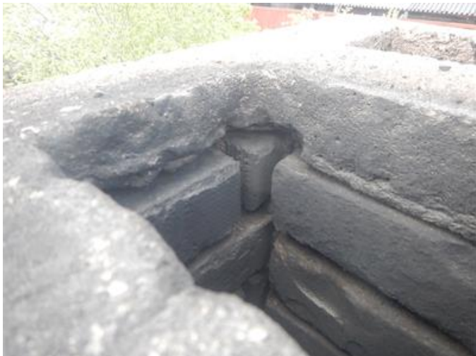
Skorstenen har eroderat i överkant.
