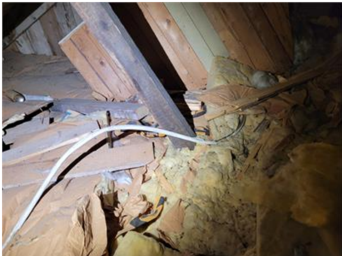
Vindsbjälklag bör städas av.
