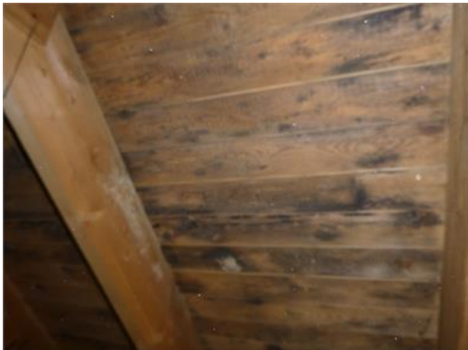
Mikrobiell påväxt på insida yttertak
