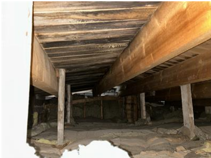
Nockvind: Mikrobiell påväxt samt lukt upplevdes.
