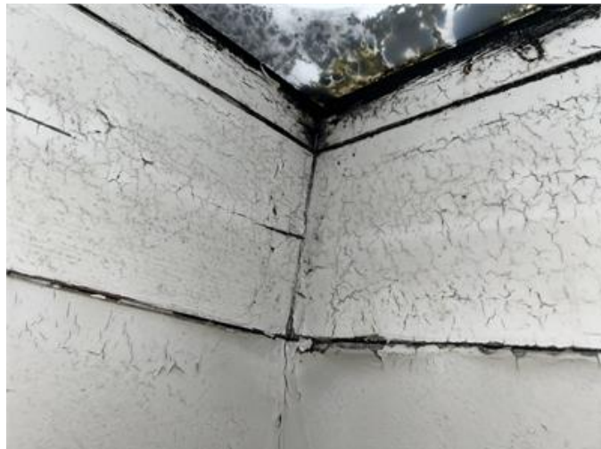
Takfönster i Bad/Wc: Mikrobiell påväxt, fuktanvisning samt rötskador.
