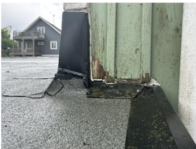
Fasad: Underhållsbehov ovan garagetak.
