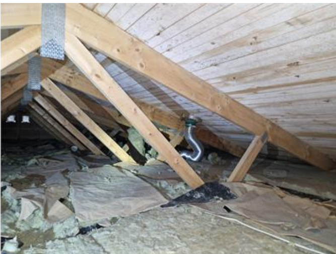
Nockvind, vitaktig mikrobiell påväxt i underlagstaket, oisolerad imkanal.
