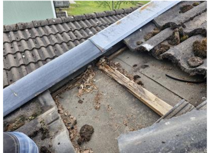
Tak, rötskada i läkt och takutsprång.
