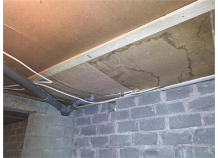
Grovkällare/Krypgrund, fuktanvisningar på flera blindbottenskvivor, bla.. under Bad/WC.
