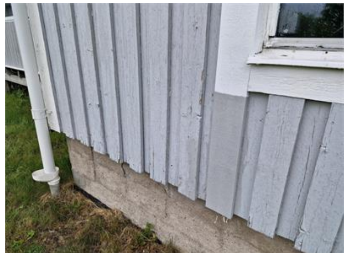
Fasad och Fönster, behov av underhåll och delvis byte.
