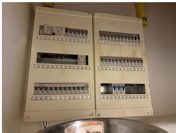
Ingen gruppförteckning över elcentralen.
