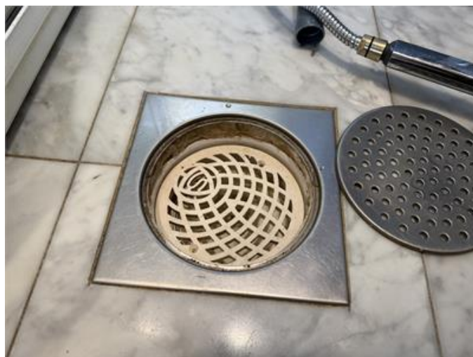
Det finns inget synligt tätskikt anslutet i golvbrunnarna (generellt).
