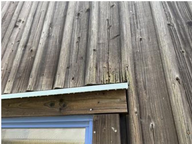
Begynnande rötskador noterades lokalt.
