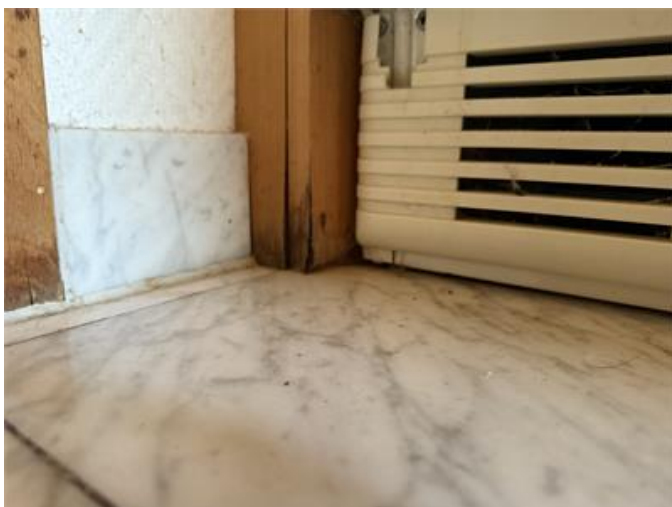
Fuktpåverkad täckskena i köket (torrt vid besiktningstillfället).
