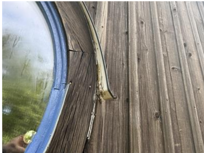
Fönsterbleck har lokalt lossnat från infästning.
