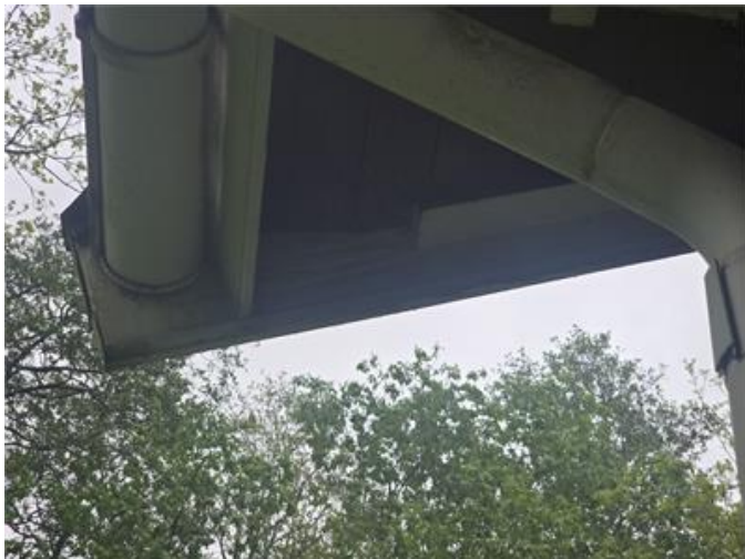
Exempelbild, rötskada vindskiva.
