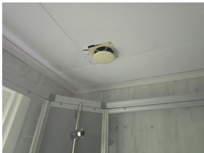
Skada innertak, dusch/wc.
