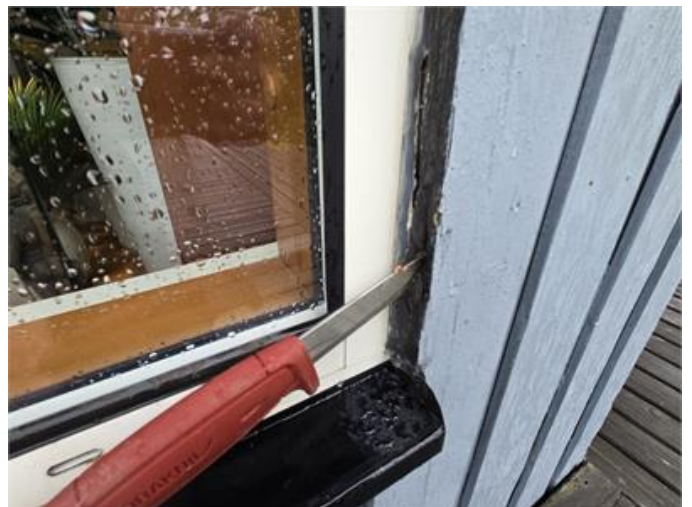
Fasad: Rötskador i fasad.
