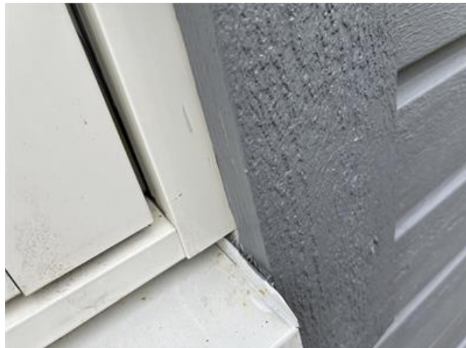
Fasad: Exempel på otäthet vid underbleck.
