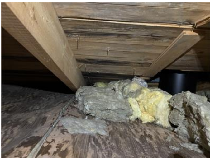
Nockvind: Missfärgningar finns på underlagstaket på några ställen, torrt vid besiktningstillfället.
