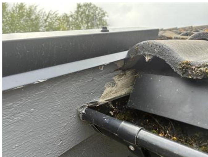
Tak: Korta vindskiveplåtar är ej invikta under pannor, mindre rötskada finns i underliggande vindskiva.
