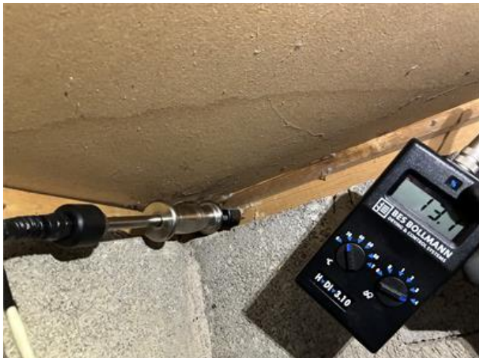
Krypgrund: Bilden visar exempel på missfärgning.
