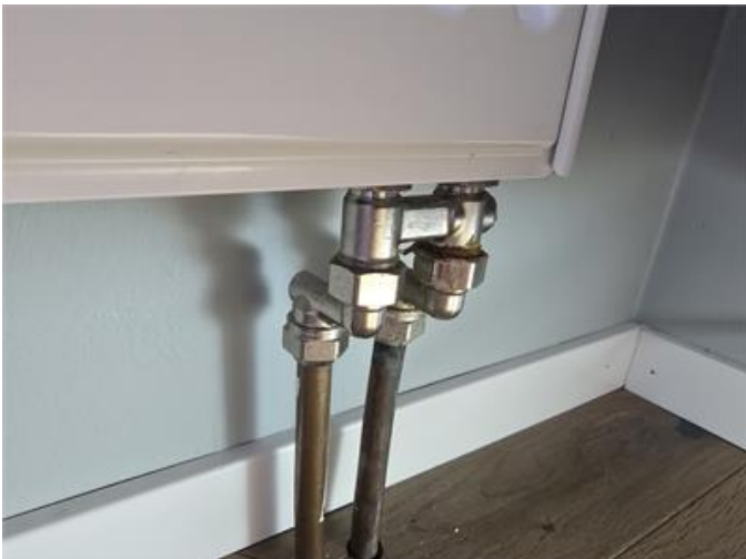
Ärg/rost på rörkoppling radiator, sovrum 2 övre plan.
