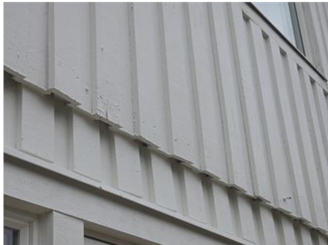
Rötskador i underkant fasadbrädor, övre plan.
