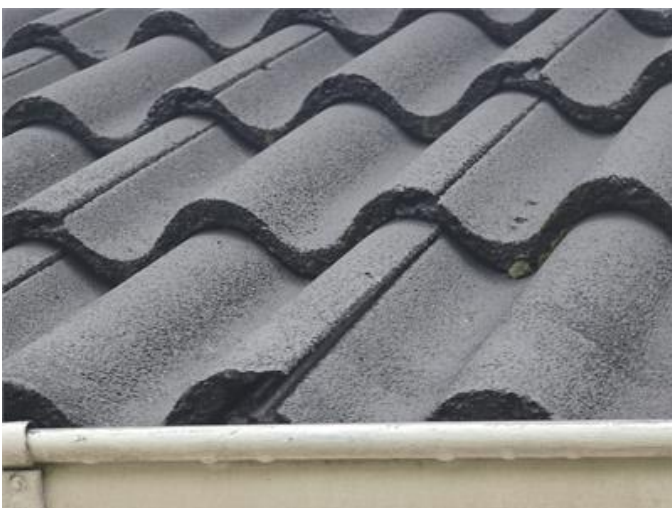
Exempelbild, takpannor som inte ligger i sitt rätta läge.
