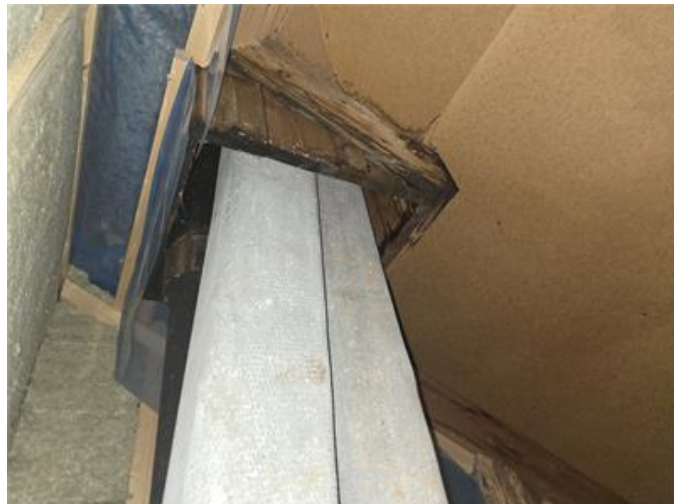
Fukthäcken i underlagstak, sidovind 1.
