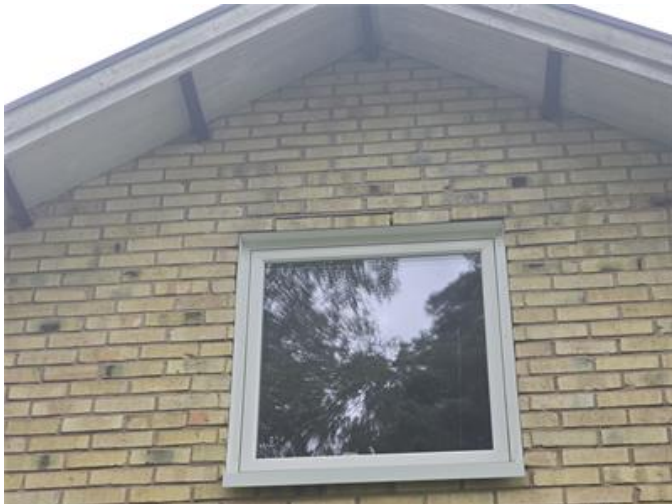
Översiktsbild, tegelfasad där delar av stenar ovan fönster släppt.
