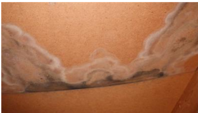
Fuktfäckar på träfiberskivorna i taket på vinden
