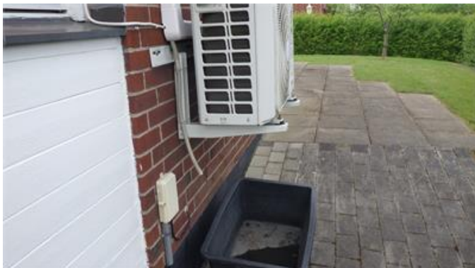
Luftvärmepumpens utomhusdel vid fasaden
