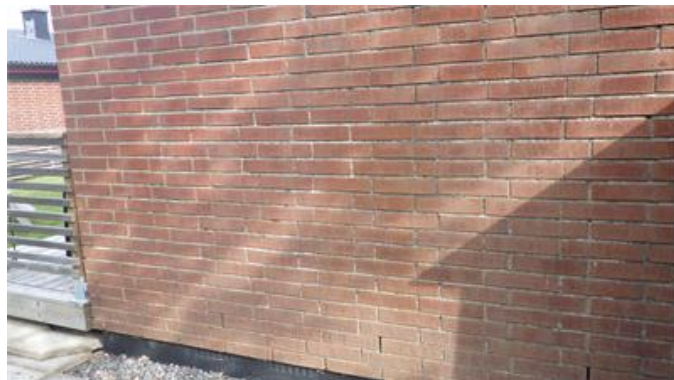
Fogar som lossnat ur fasaden
