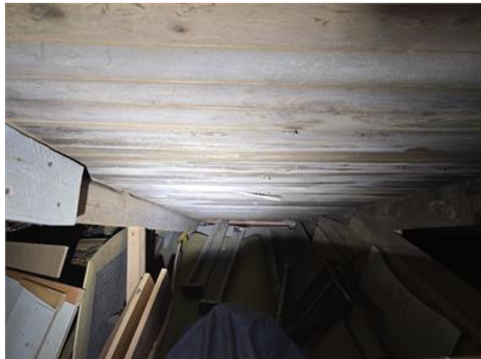
Exempelbild, mikrobiell påväxt underlagstak, vind.
