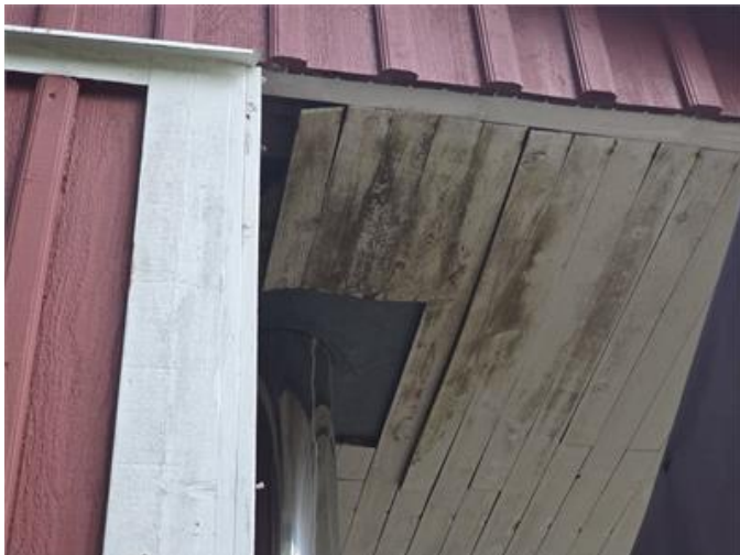
Exempelbild, skada i takfot kring genomföring för rökrör.
