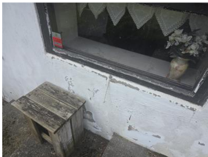
Exempelbild, målning/underhållsbehov äldre fönster.
