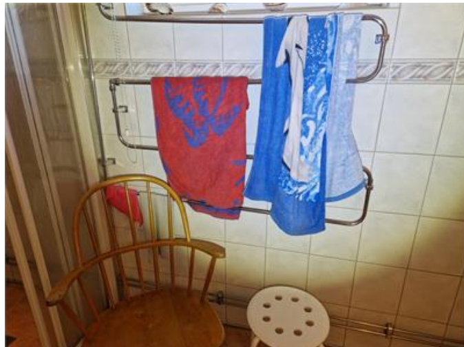
Dusch/Wc: Rörinstallationer på vägg används som handdukstork.
