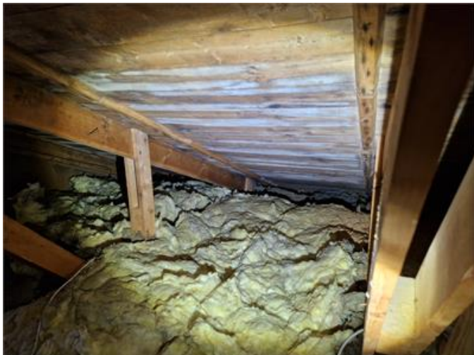
Vind: Mikrobiell påväxt förekommer i underlagstak.
