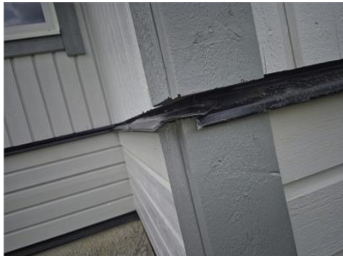
Bristfälligt utförda plåtarbeten.
