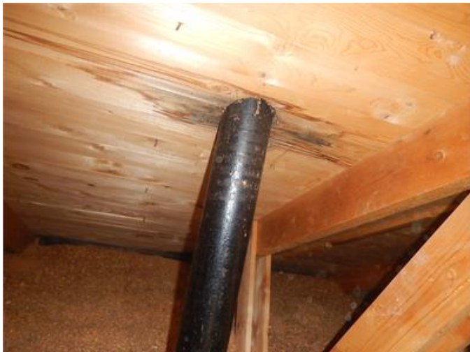
Fuktpåverkan på underlagstak vind.
