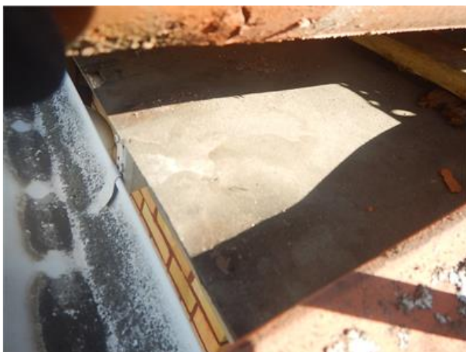
Sliten och torrsprucken takpapp.
