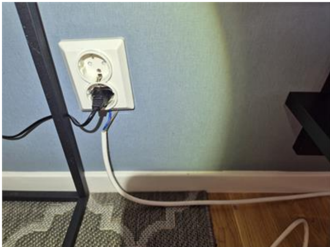
Bild på bristfällig elinstallation.
