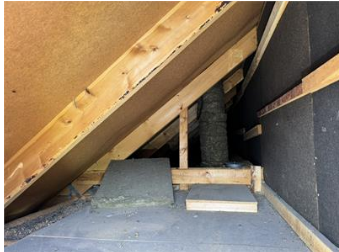
Mindre fuktfläckar på underlagstak i sidovind.
