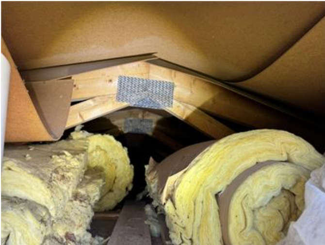
Masonitskivor under plåttak på garage hänger ned och bör justeras/kompletteras.
