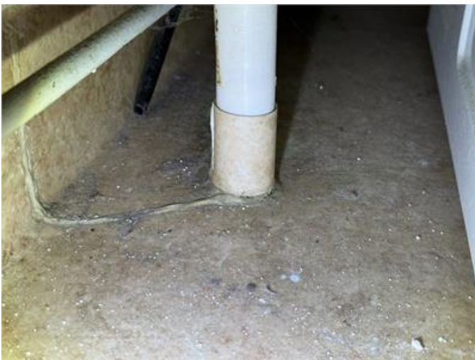
Plastmattan är otät vid rörgenomföring i tvättstuga.
