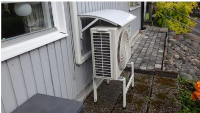
Värmepumpens utomhusdel vid fasaden
