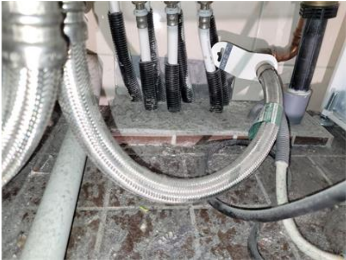
Rör genomföringar i golvlack
