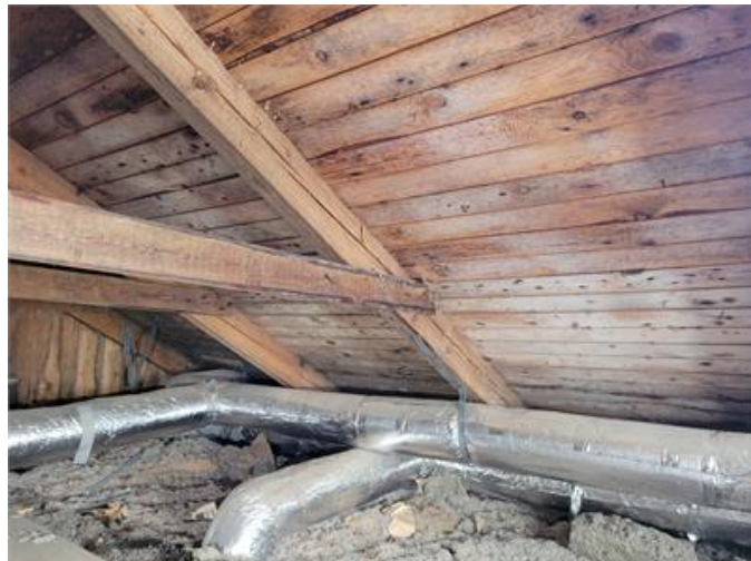
Mikrobiell påväxt på underlagstak.
