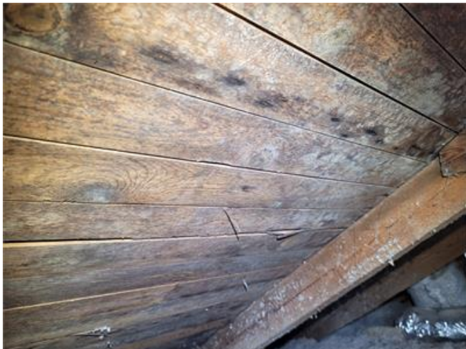
Mikrobiell påväxt på underlagstak.
