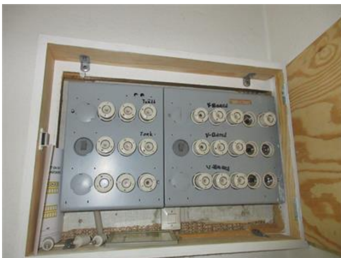
Äldre el-central som saknar propphylsor och gruppförteckning
