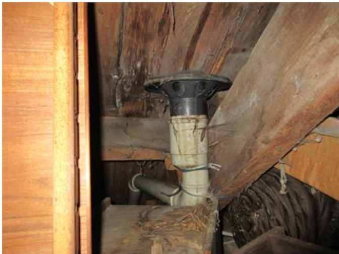
Vakumventil i vind
