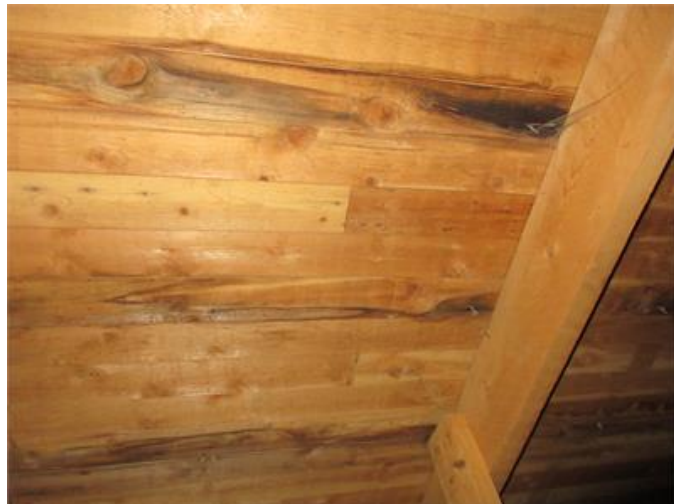
Exempel på missfärgningar insida yttertak i vind
