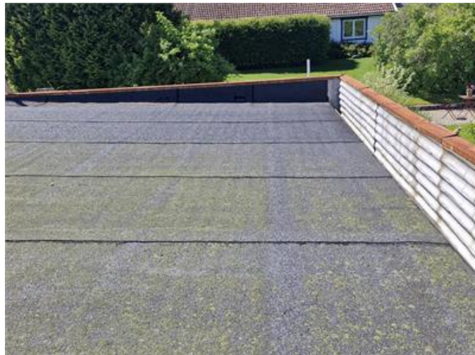
Tak Garage, äldre med släpp vid takfot och rostangrepp på plåtar.
