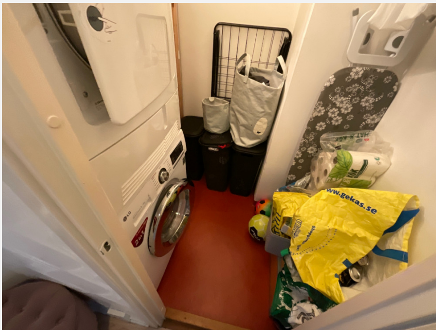
E1 Tvättmaskin - Tvättmaskin installerad i utrymme utan golvbrunn. Vattenlås / spillvattenledningar bristfällig
