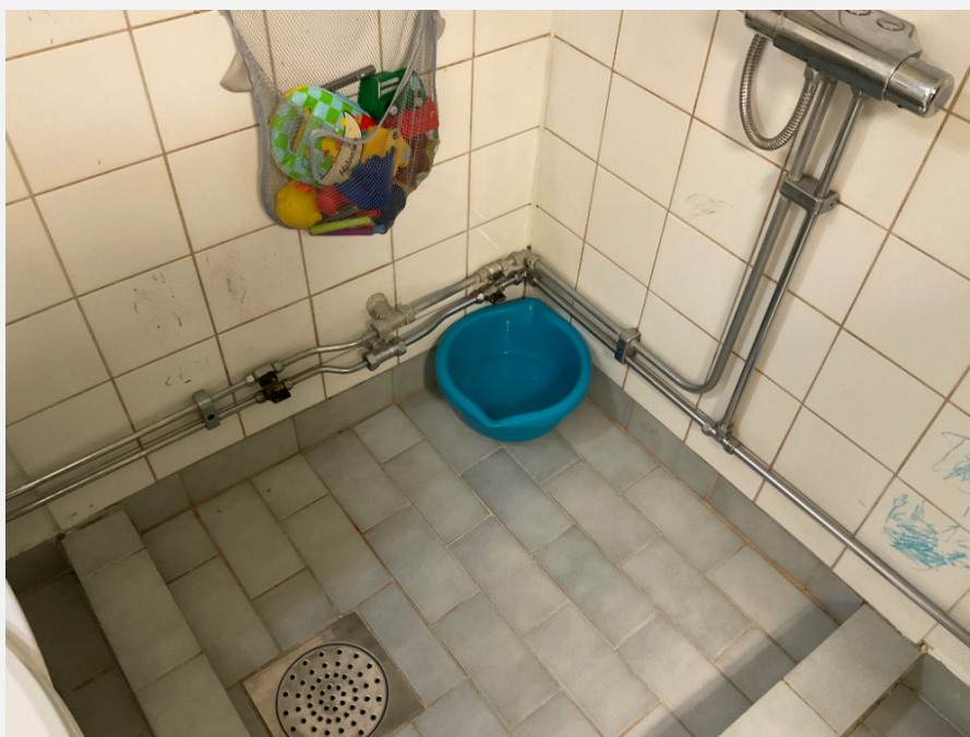
U2 Övrigt - Genomföringar i plats för dusch
