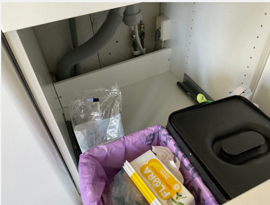
U7 Övrigt - Läckageskydd diskbänkskåp saknas
