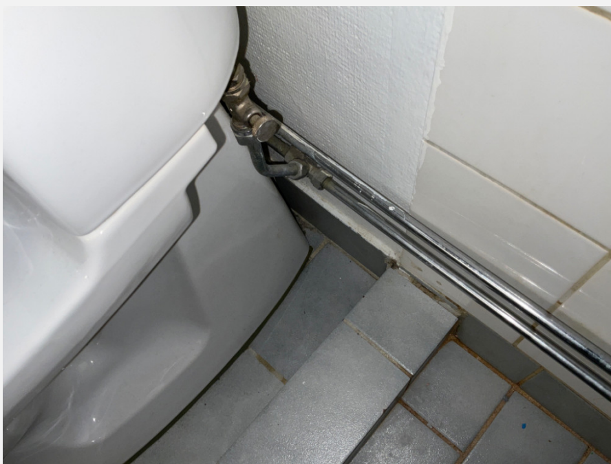
U5 Övrigt - Avsättning wc placerad för nära vägg
