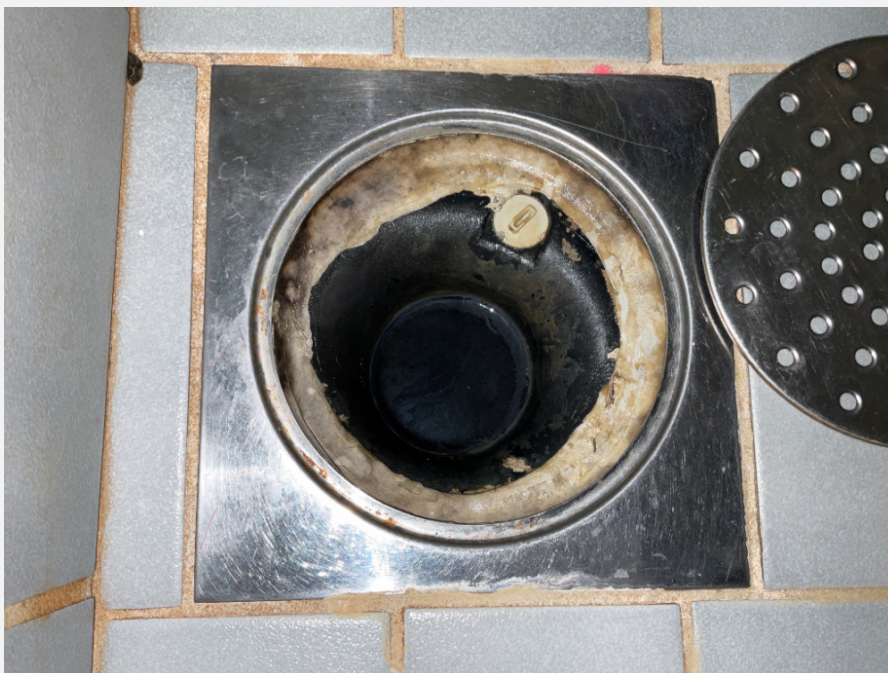
U4 Övrigt - Äldre golvbrunn, keramik förmodligen monterad ovanpå plastmatta
