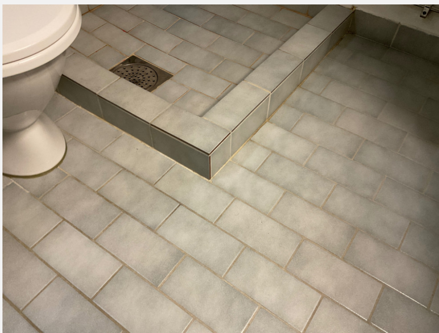
U3 Övrigt - Upphöjd klack hindrar avrinning ned mot golvbrunn på utläckande vatten utanför duschen
