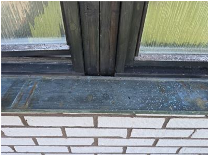
Exempel på otätheter vid fönsterbleck. Skador i bakomliggande konstruktion kan inte uteslutas.
