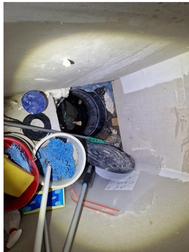
Trappförråd: - Ej gjutet golv i utrymmet. - Brunn och pump för vatten finns i utrymmet.
