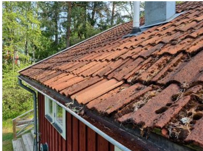
Del av takfot på framsidan med rötskador
