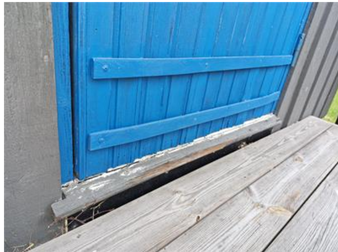
Dörrar, förrådsdörr skadad i nedre delen och glipar mot karmen.
