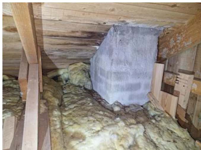
Nockvind, torr fuktanvisning vid murstock.
