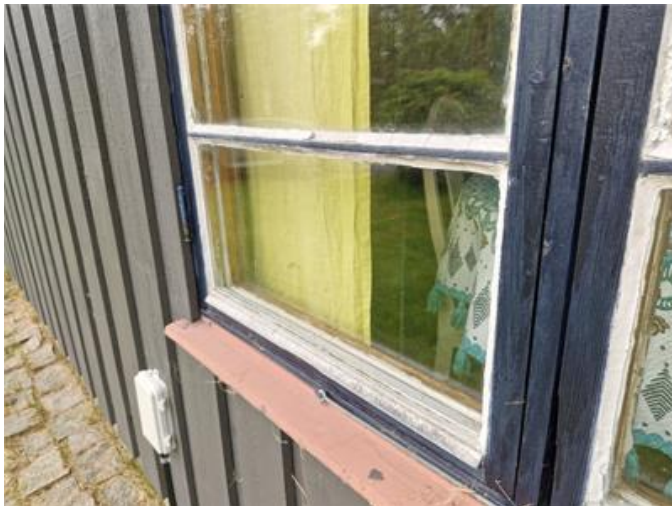
Fönster, äldre med underhållsbehov.
