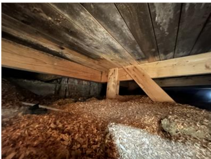
Nockvind: Mikrobiell påväxt i underlagstaket.
