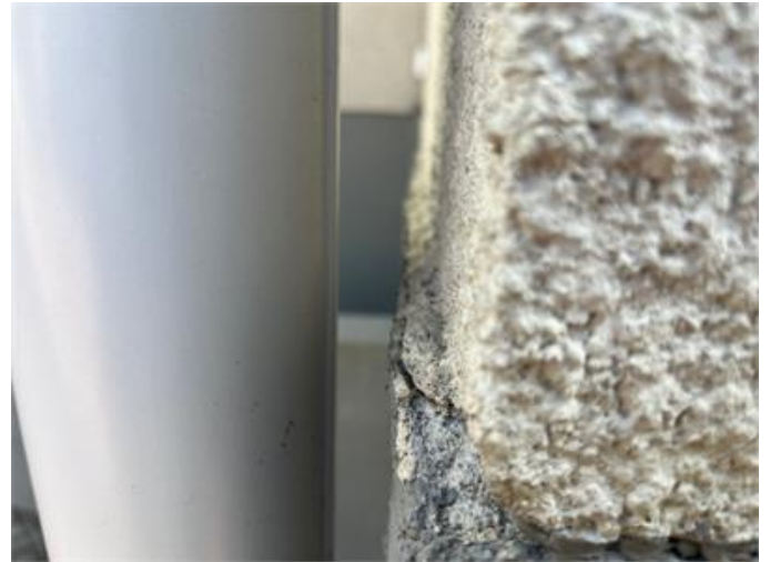
Sockeln går bitvis utanför fasaden vilket kan medföra ökad fuktbelastning mot bakomliggande konstruktion.
