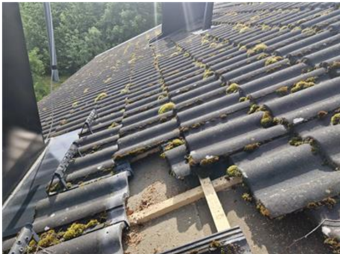
Tak översiktsbild med kontroll under pannor.
