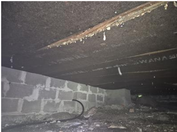
Bild från krypgrund, rötskador noterades i bjälklagsbalk bakom asfaboard.
