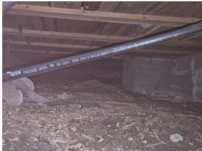
Bild från krypgrund. Fuktig och mikrobiellt angripen mark.
