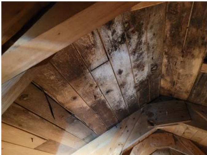
Mikrobiell påväxt på underlagstak.
