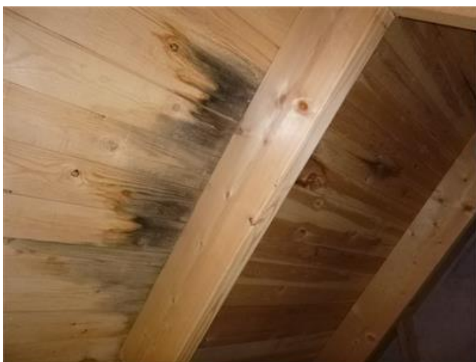
Bilden visar missfärgning på vinden.
