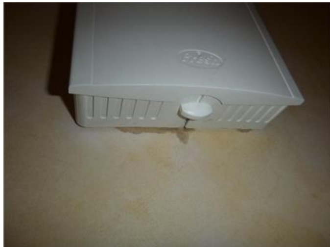
Bilden visar missfärgning vid väggventil.
