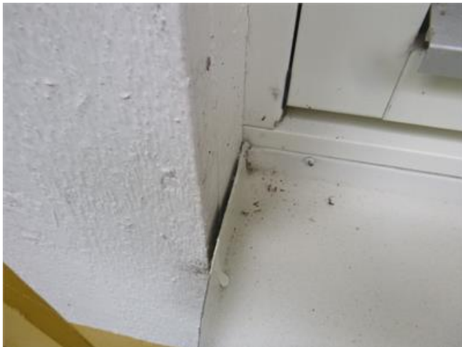
Bilden visar exempel på otätheter/brister vid/med plåtdetalj.
