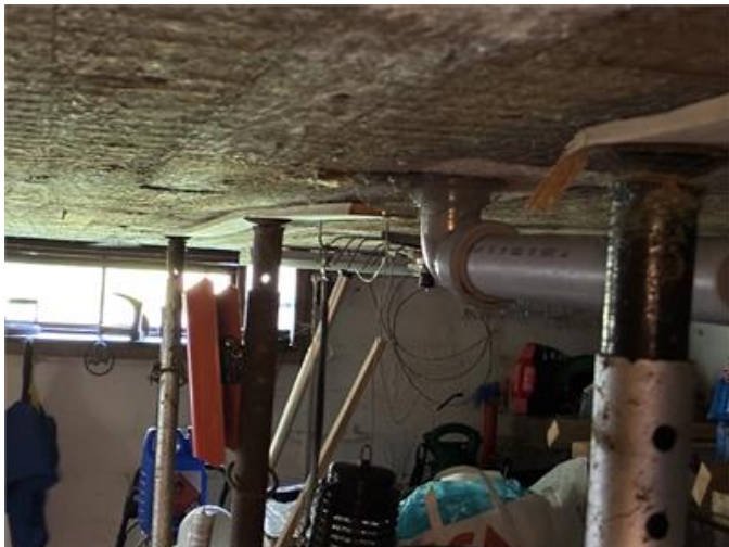
Källare: Bjälklaget är stöttat med skruvstämp och hänger ner mellan stämpan.
