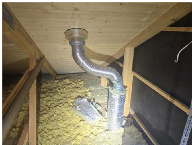
Oisolerat rör från köksfläkt, vind.
