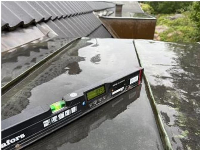
Taklutningen är låg/obefintlig på takkuporna.
