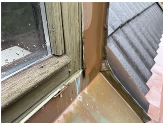
Otäheter mellan plåtbeklädnad och fönster (takkupa).
