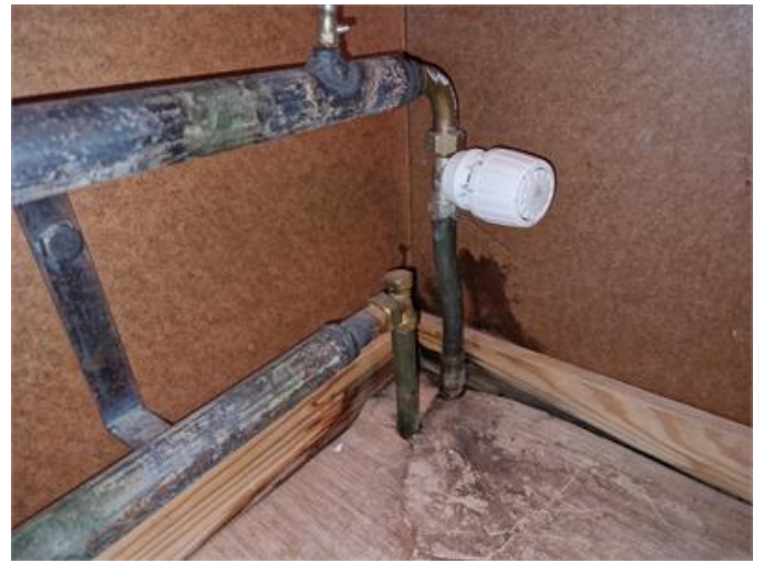
Fuktskada vid radiator i förråd, för dagen torr.
