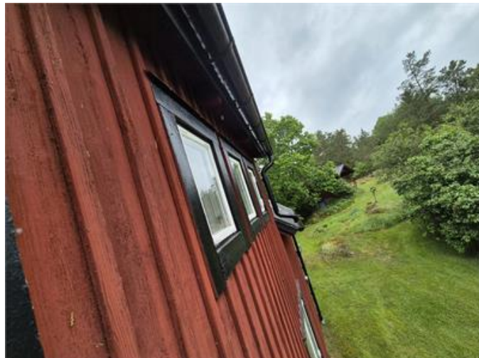
Fönsterbleck saknas på fönster.
