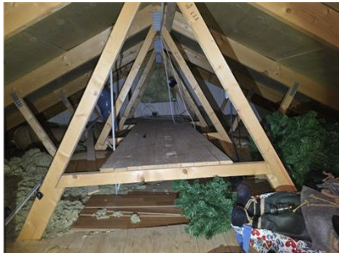
Nockvind: Översiktsbild ovan Garage/Tvätt/Dusch/Pannrum.
