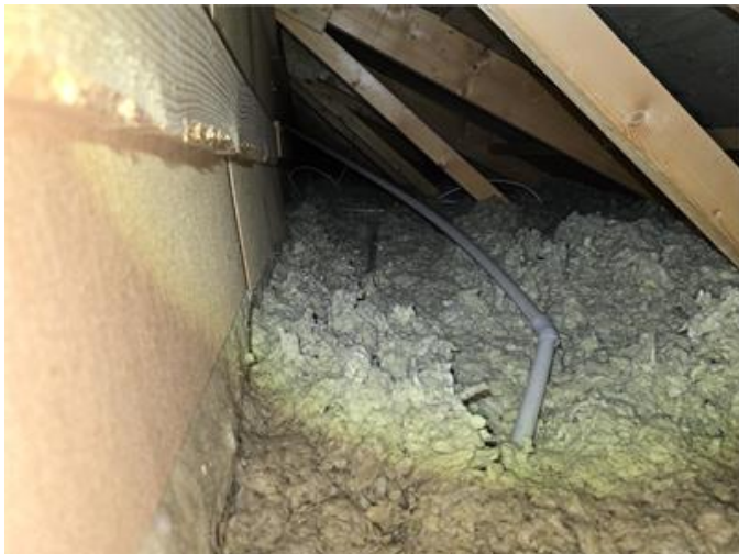
Sidovind: Översiktsbild, oisolerade elinstallationer i utrymmet.
