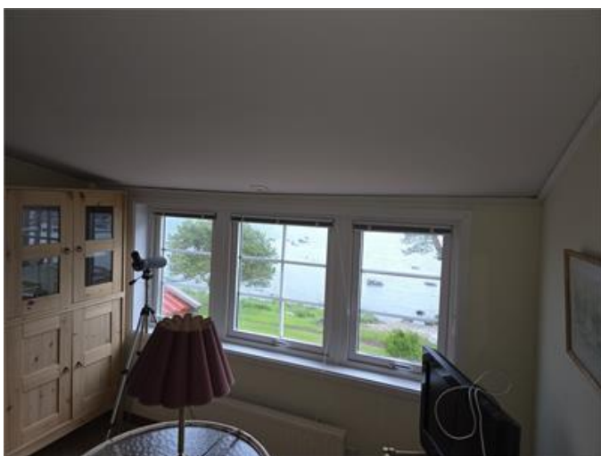
Bågnande/lutande del mellan tak ovan fönster på övre plan.
