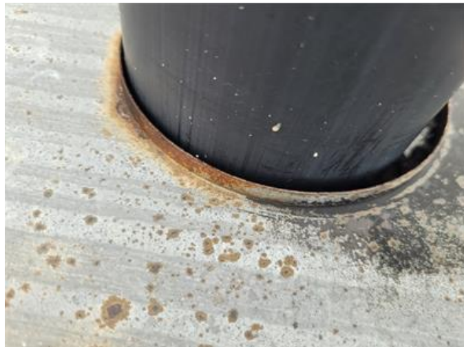
Otätthet invid avloppsavluftningen.
