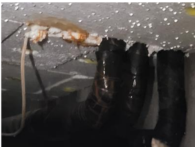
Läckage från värmepannan sett från krypgrund.
