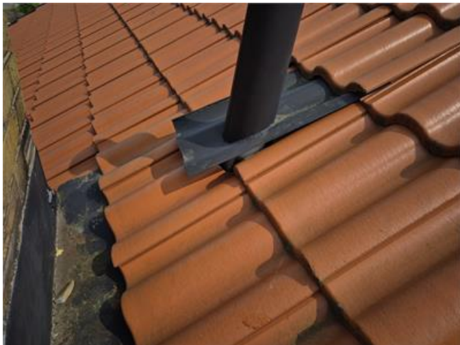
Plåthuv avluftning avlopp behöver justeras då det förekommer glipor mot takpannor.
