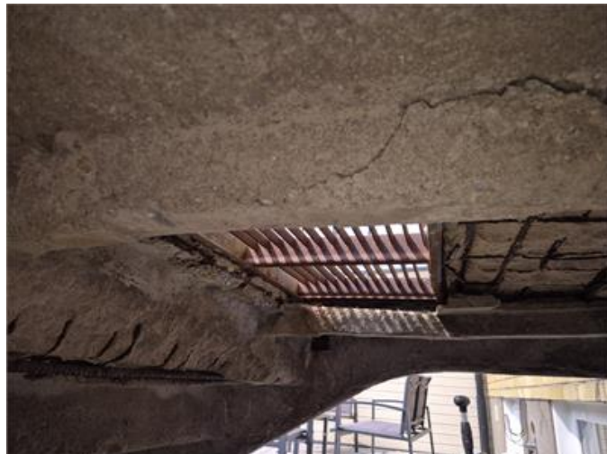
Betongskador i entrétrappa.
