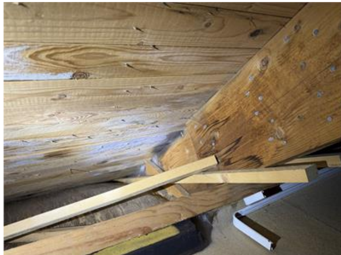
Översiktsbild på vind, exempel på spår av läckage och mikrobiell påväxt
