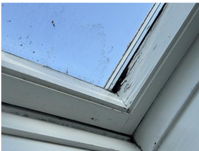
Fuktrelaterad skada i takfönster, badrum övre plan
