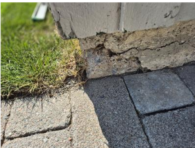
Sprickor i sockeln.
