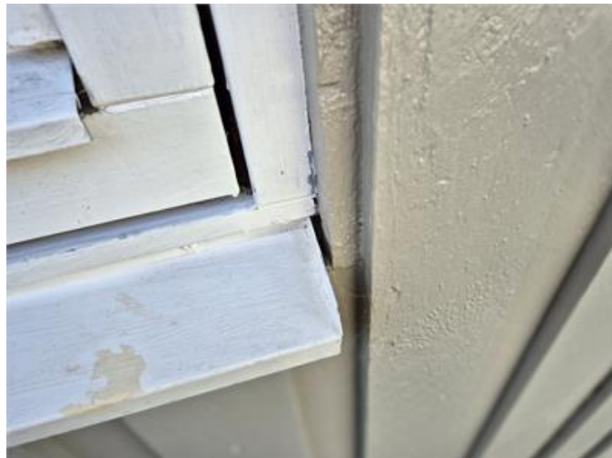
Otätheter vid fönsterbleck.
