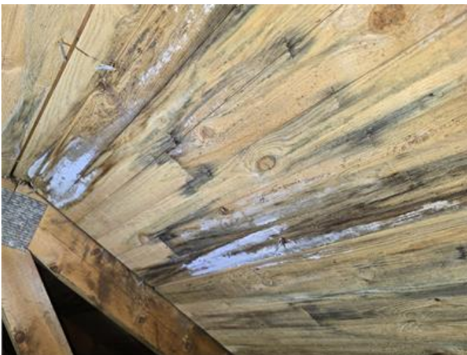
Nockvind: Mikrobiell påväxt/missfärgningar i underlagstak.
