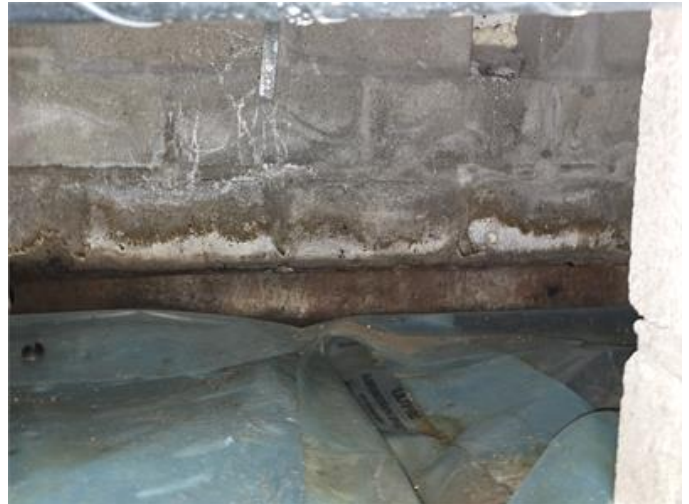
Krypgrund: Fuktgenomslag i nerderkant grundmur.
