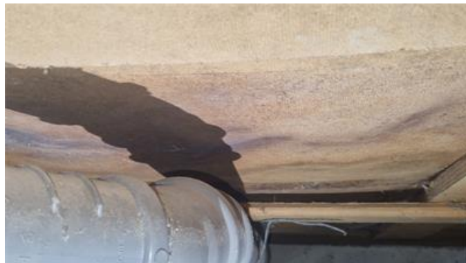
Bilden visar fuktfläckar på trossbotten skivor i grunden
